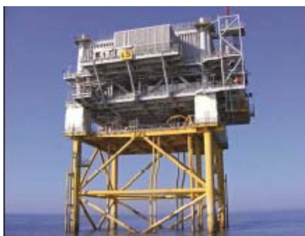
Figure 6 : Illustration de la sous-station électrique envisagée pour le projet (STX) (Source : étude d'impact)
